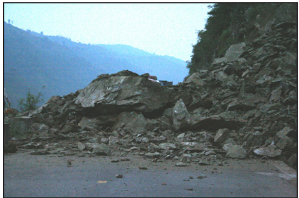
洵陽一安康間の崖崩れ
